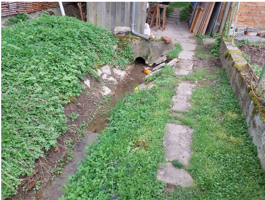
Abbildung 31: Einlauf im Wiesenweg mit Optimierungsbedarf (Ortsbegehung am 18.04.2023)
