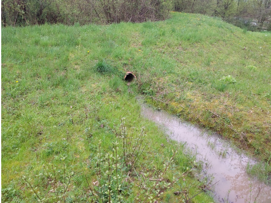
Abbildung 30: Bereich zur Ableitung des Oberflächenwassers ins Rebflurbecken Rosenberg (Ortsbegehung am 18.04.2023)
